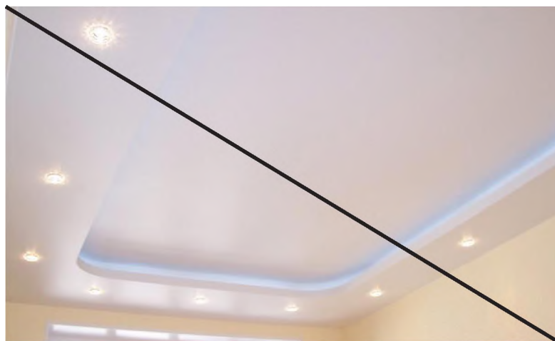
Плохо Многоуровневые гипсокартонные конструкции
