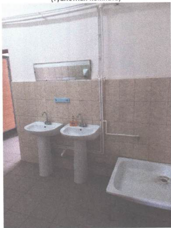
№51. Санитарно-бытовые помещения (туалетная комната)
