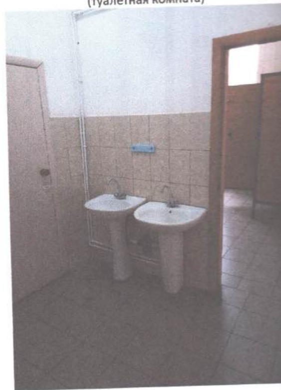
№48. Санитарно-бытовые помещения (туалетная комната)
