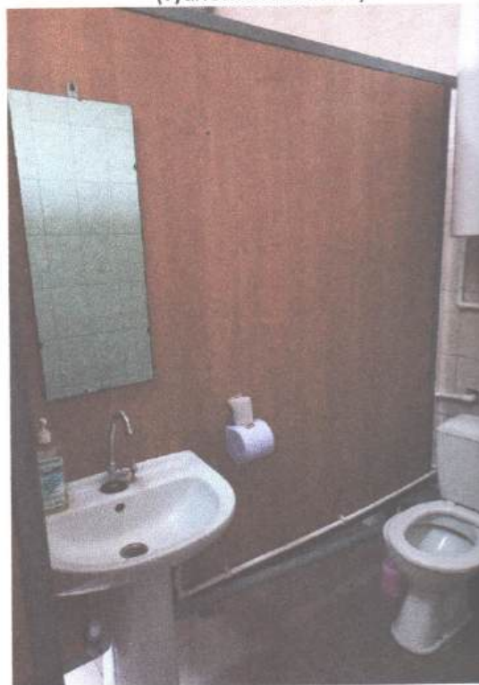
№52. Санитарно-бытовые помещения (туалетная комната)
