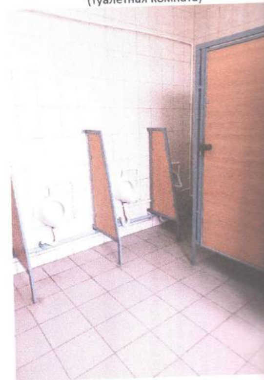
№50. Санитарно-бытовые помещения (туалетная комната)
