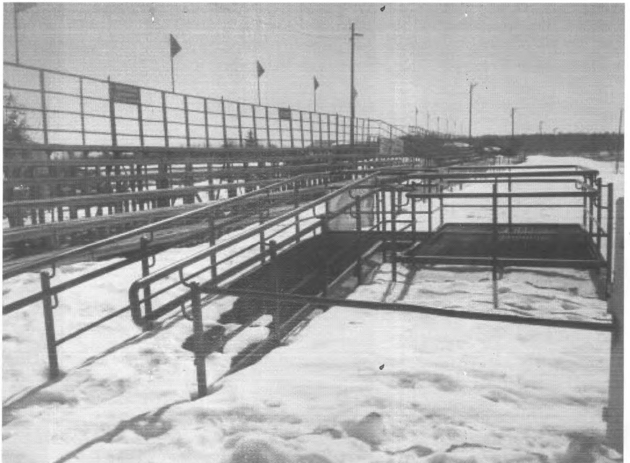
фото № 22 пандус – площадка у зрительных трибун на стадионе, установлено после паспортизации
