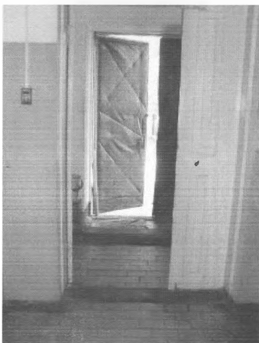
фото № 20 выход эвакуации, пожарная сигнализация
