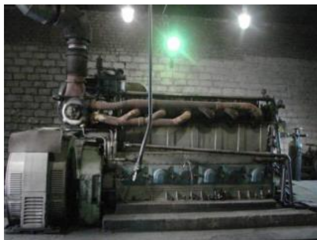
Старый генератор в том же здании (не эксплуатируется)
