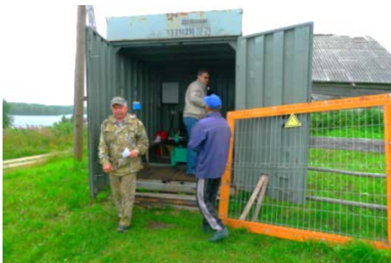
Рисунок 8: Дизельная электростанция в Юстозеро, генератор установлен в небольшом контейнере.
