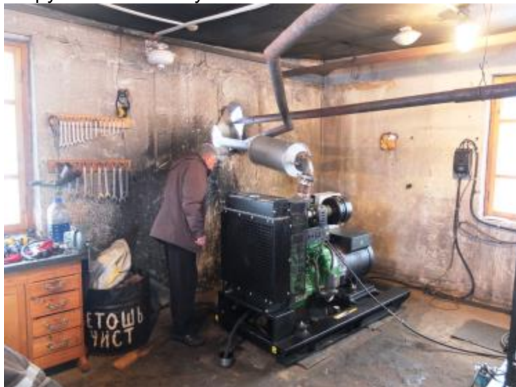
Рисунок 6: Дизельная электростанция в п Кимоваара, Дизель генератор - 32 кВт.
