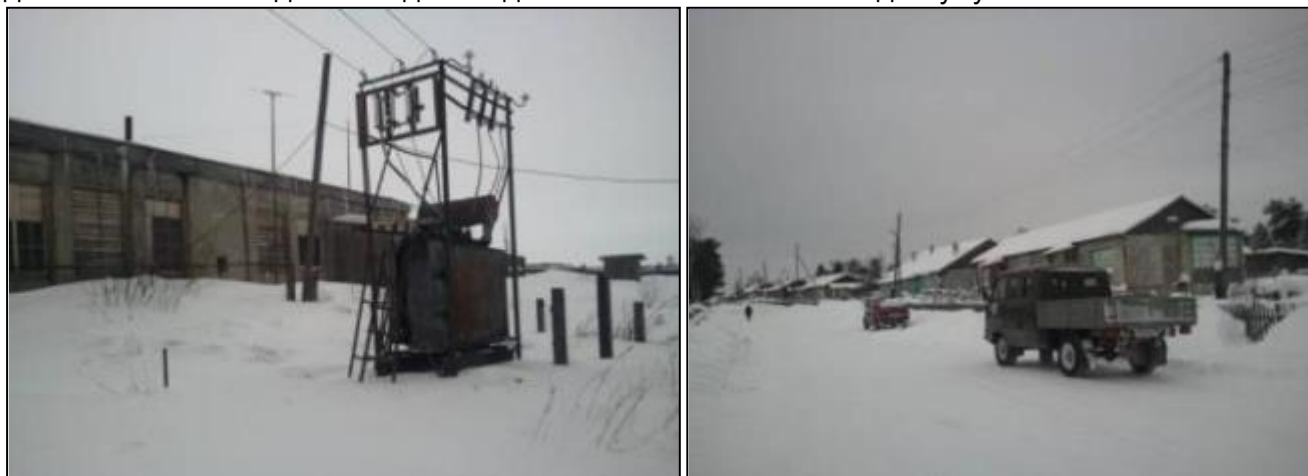
Рисунок 11: Один из повышающих трансформаторов и воздушная линия передач в Валдае
